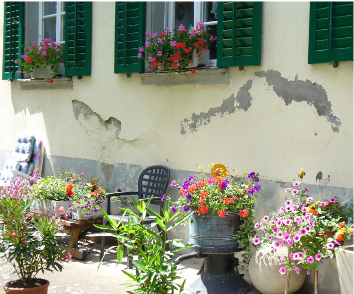
Schadensbild an einer Fassade mit sichtbaren Putzablösungen.
