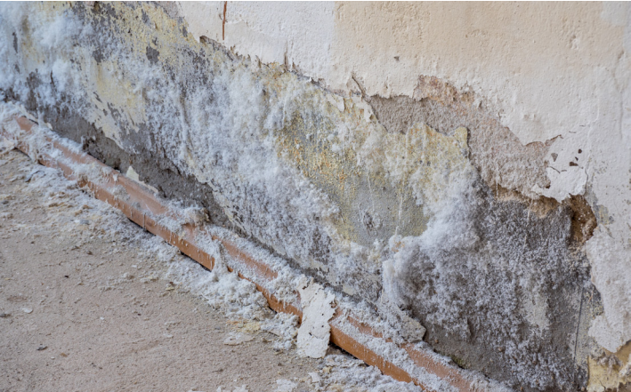
Salzausblühungen als sichtbares Zeichen feuchter Bausubstanz.
