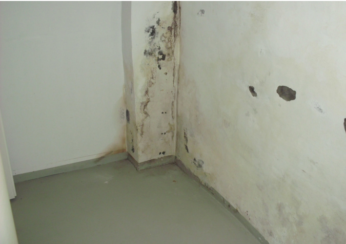
Abplatzungen am Mauerwerk weisen auf Feuchtigkeitsschäden hin.
